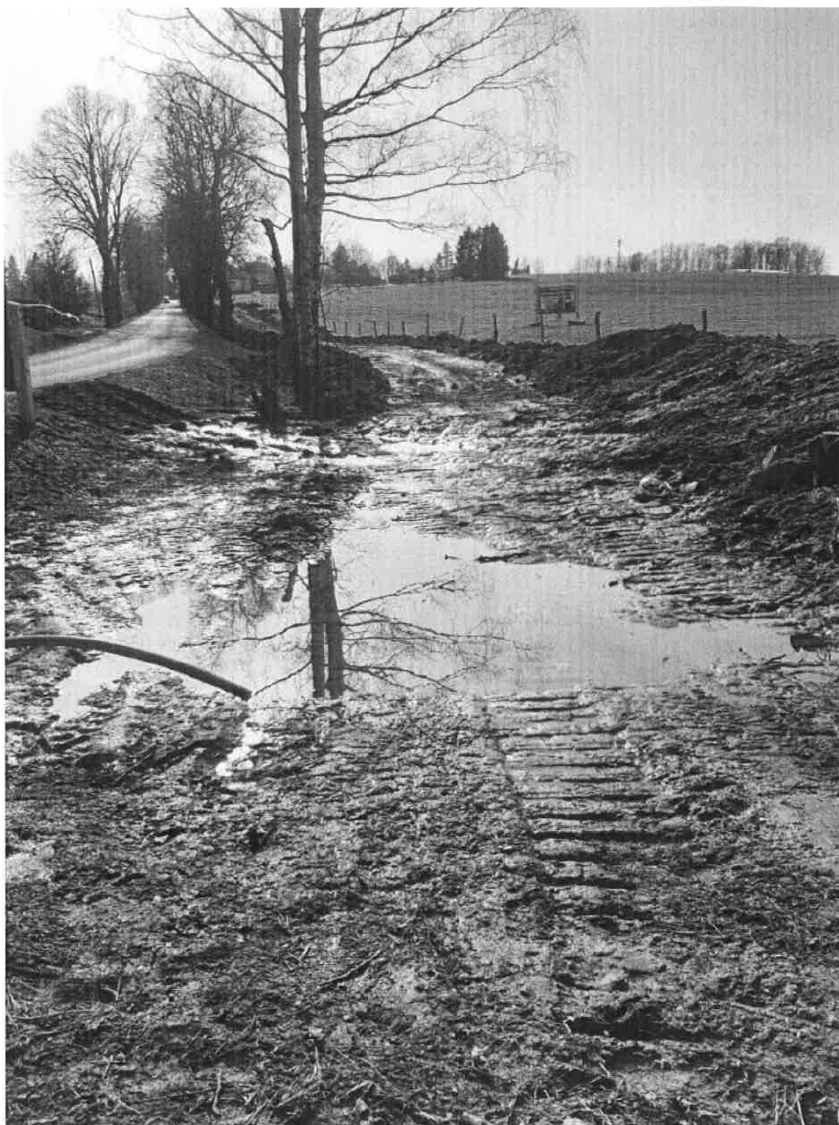
ZL č. 4 – zvodnělá místa, které je nutno odvodnit novými propustky
